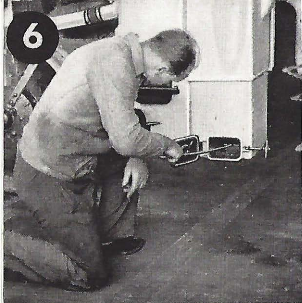
Bild 6. Der Staub, der sich im Betrieb im Grobreiniger angesammelt hat, wird durch die geöffnete Aschetür mit einem Kratzer sorgfältig entfernt.
