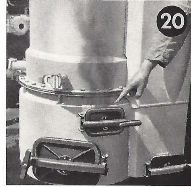
Bild 20. Zur Prüfung auf Undichtigkeiten wird der Motor abgestellt und die Luftklappe am Mischer geschlossen. Die schadhafte Dichtung raucht.
