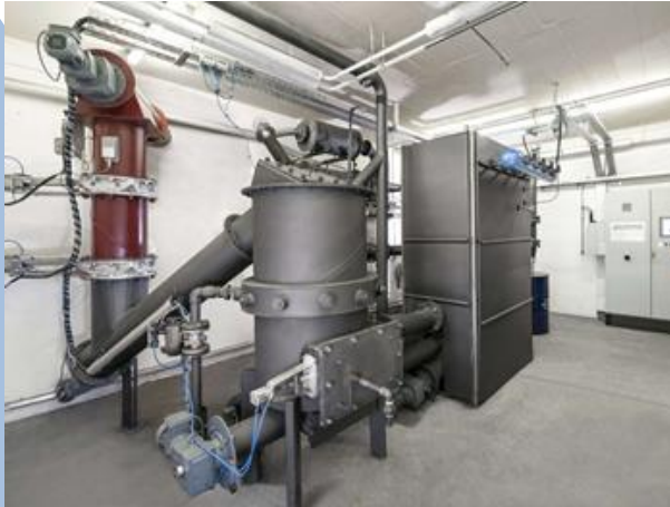
65 kWel plant from Holzenergie Wegscheid GmbH
